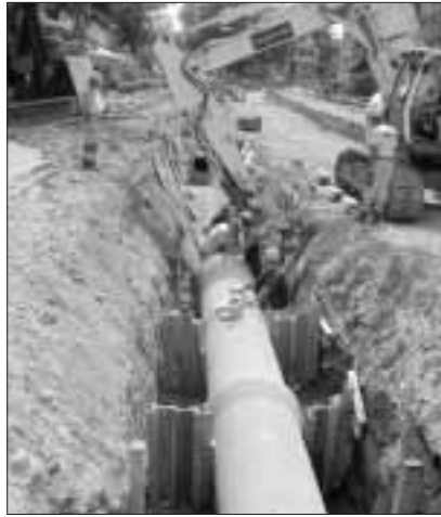
Abwasserleitung: Bei den Arbeiten handelt es sich um eine Abwasserleitung für das Regenwasser (Trennsystem). Dieser Kanal wurde während des Umbaus am Kronenplatz erstellt.
